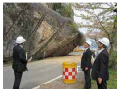
平成29年4月20日 県道西浅井マキノ線(海津大崎)、 降雨による土砂崩れ現場
